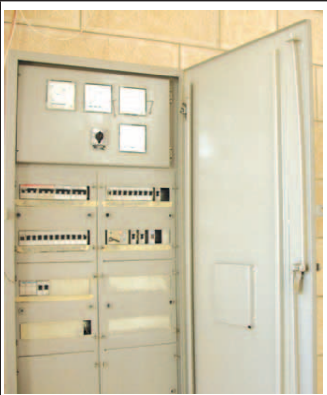
الشكل (١٣-١) : لوحة توزيع كهربائية مثبتة لمنشأة صناعية
