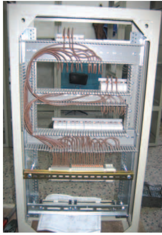
الشكل (٨-١٤) : تمديد الأسلاك والكوابل داخل الترنكات المفتوحة بشكل مستقيم (داخل المجاري البلاستيكية)
